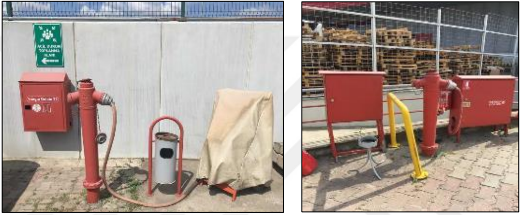
Resim 8: Bina Dahili İtfaiye Su Bağlantıları
