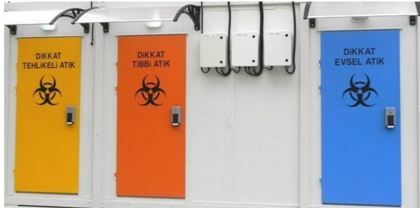
Şekil 2.3: Tıbbi Atıkların Geçici Depolanması (İzmir, 2018)
